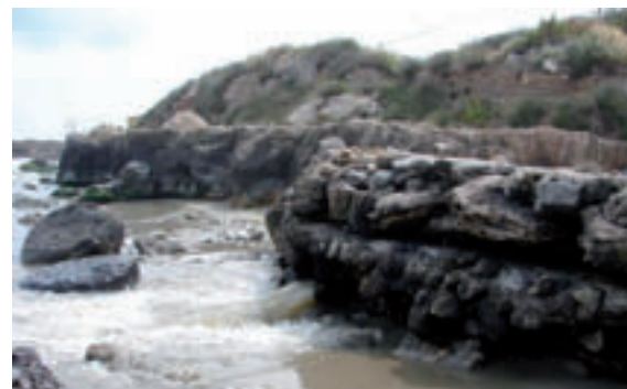
Lo scarico oggi
